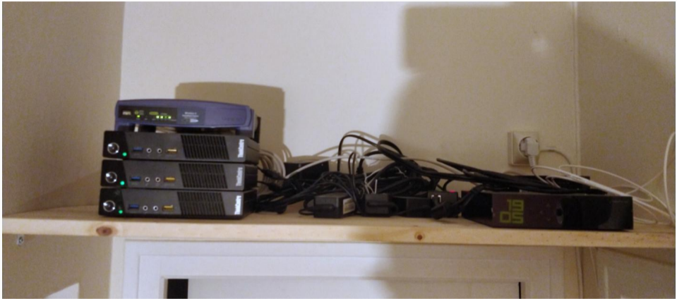
Figure 3: Site Deuxfleurs avec 3 serveurs (PC de bureau reconditionnés) et 2 routeurs
